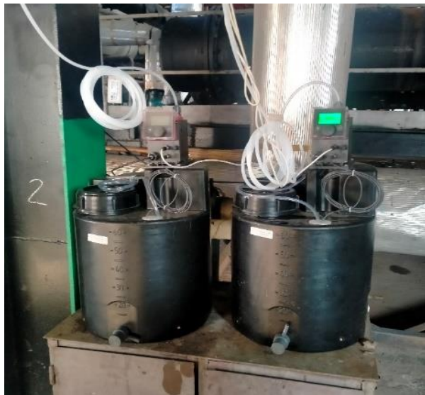
Станция дозирования химических реагентов
